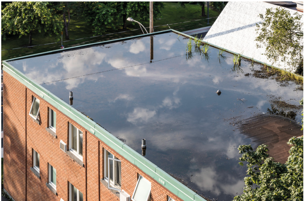
Figura 1: Encharcamiento en una cubierta plana típica
