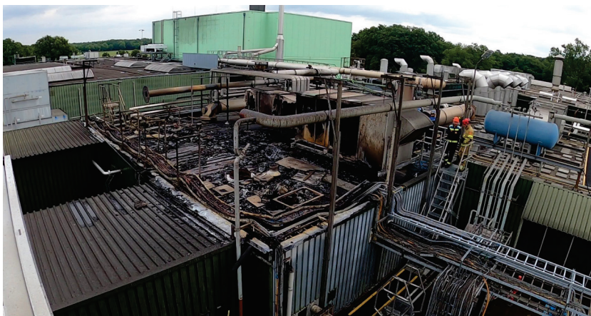
Figur 6: Oversigt over det beskadigede tag. Bag ventilationsanlægget er en del af taget også brændt (kilde: Aviko).
